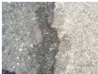
施工面の窪み
