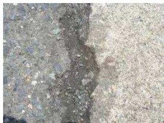
施工面の窪み
