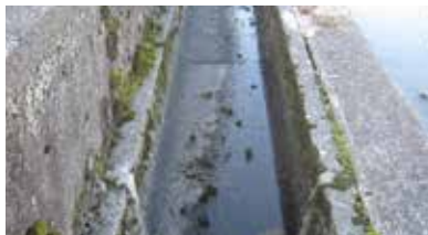
老朽化した水路
